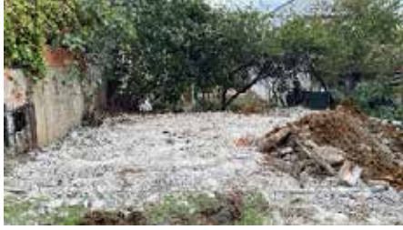
Yıkım Sonrası Metruk Bina
