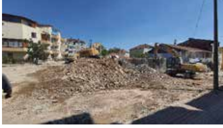
Yıkım Sonrası Hasarlı Bina
