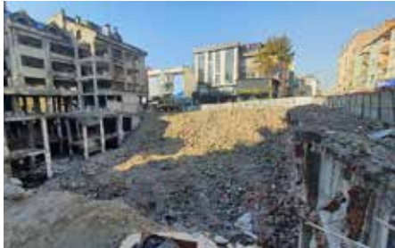
Yıkım Sonrası Riskli Bina
